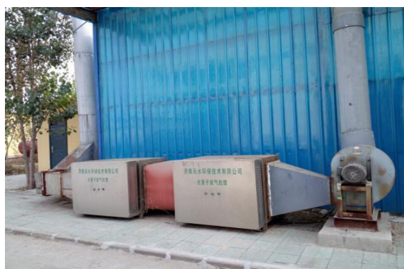
光量子廢氣處理設備
