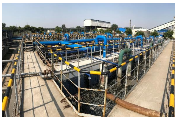
中峰化學污水處理池
